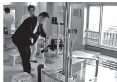
主に車いすのお客様が使用する貸切風呂に設置された入浴リフト
