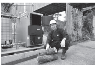
2015年に導入された薪ボイラー
